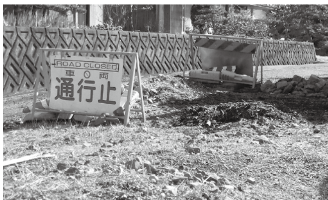
通行止めの現状
