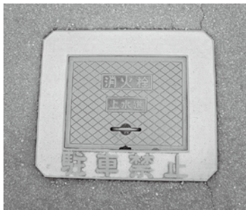
町内各所に設置してある消火栓
