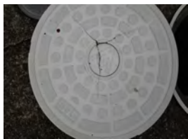
▲割れてしまった公共汚水ますの蓋
