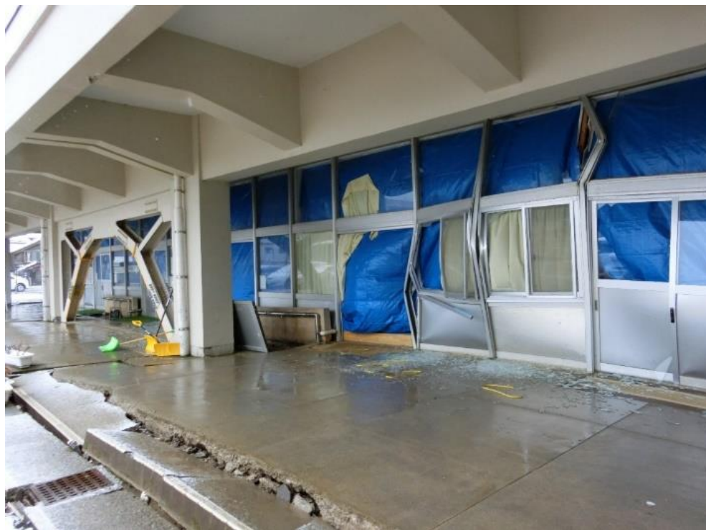
輪島市立河井小学校の被災の様子(令和6年1月13日)
